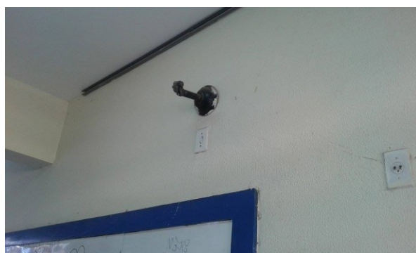
Figura 4. Ausência de ventiladores. Fonte: Alunos
