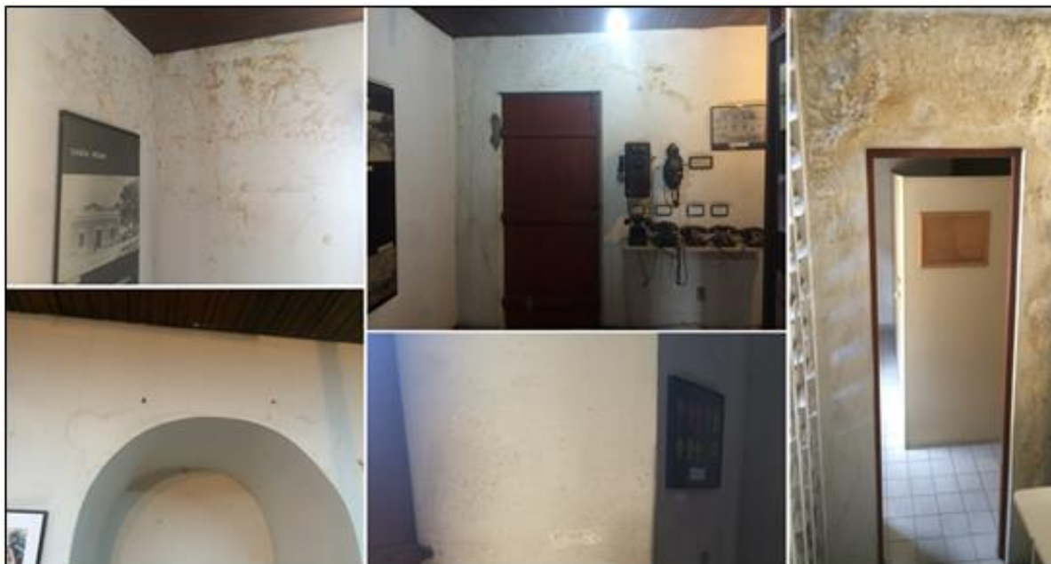
Figura 4 – Presença de Mofo.
