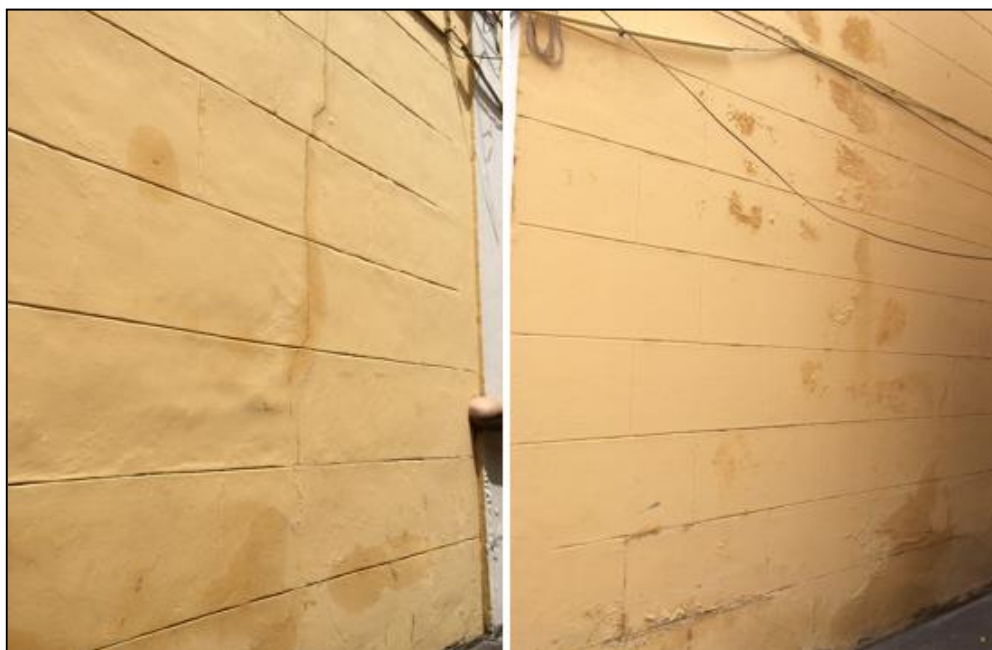
Figura 8 – Parte externa da edificação com fissuras e infiltrações.
