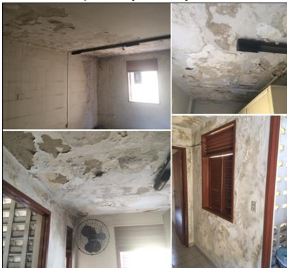
Figura 5 - Empolamento da pintura.
