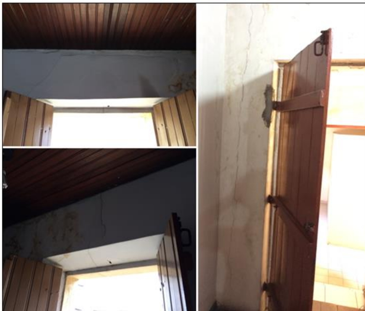
Figura 7 – Fissuras nas estruturas.
