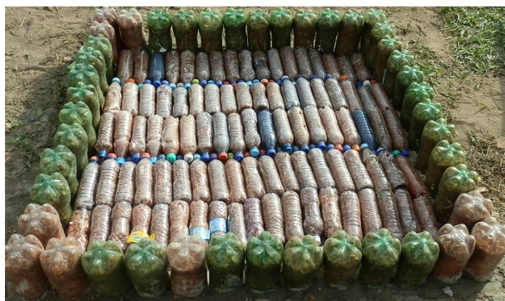
Figura 4 - Garrafas preenchidas com pó de serra, posicionadas, formando a estrutura do AcquaPET.
