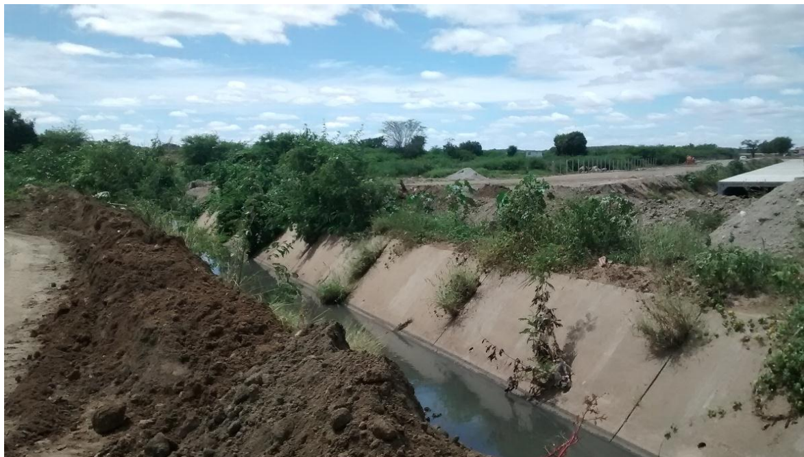
Figura 03. Esgotos lançados no leito do Rio Paraíba, ao lado das obras da Transposição
