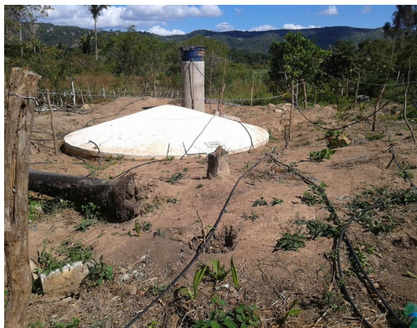
Quadro 5: Dados da cisternas de placas de Meruoca e Reriutaba
