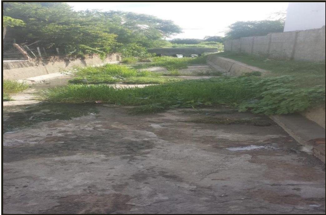
Figura 3. Canal de drenagem utilizado para escoamento clandestino de esgotos domésticos no centro da cidade, Patu/RN.
