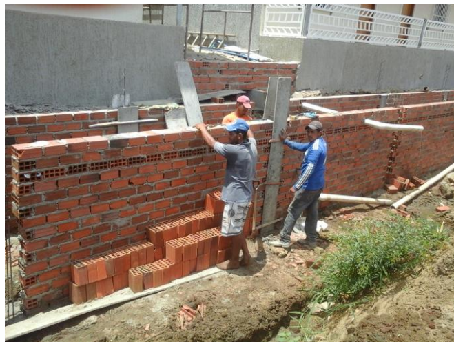
Figura 03 – Trabalhadores sem EPI's e em condições insalubres
