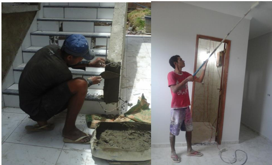
Figura 02 – Trabalhadores sem EPI's
