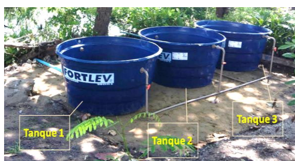
Figura 2: Sistema de tanques montado na UFCG
