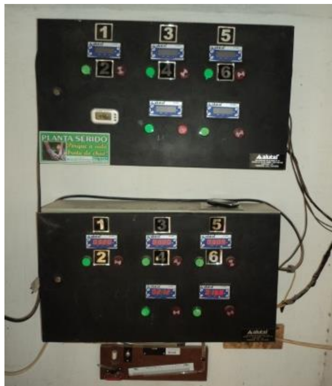
Figura 10 - Painel de registro das temperaturas aferidas nos termopares.
