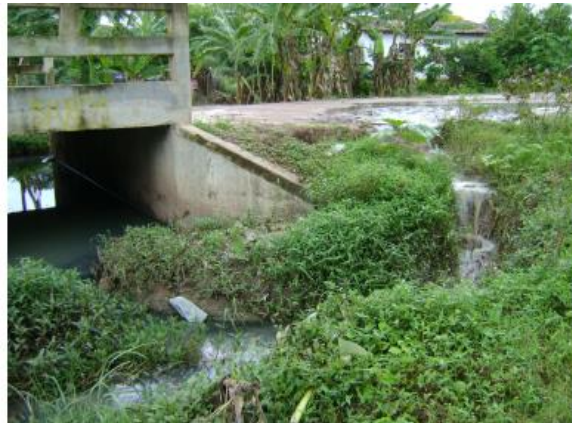
Figura 4. Galeria pluvial localizada próximo ao Rio Cabelo, João Pessoa-PB.
