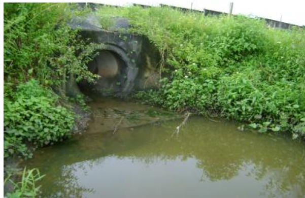
Figura 2. Tubulação com lançamento de efluente localizada próxima a nascente do Rio Cabelo, João Pessoa – PB.
