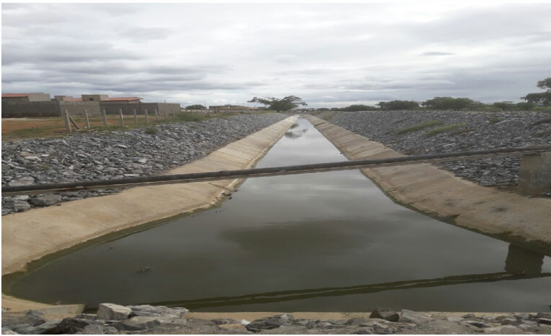
Figura 2: Canal de esgoto oriundo do município de Monteiro-PB
