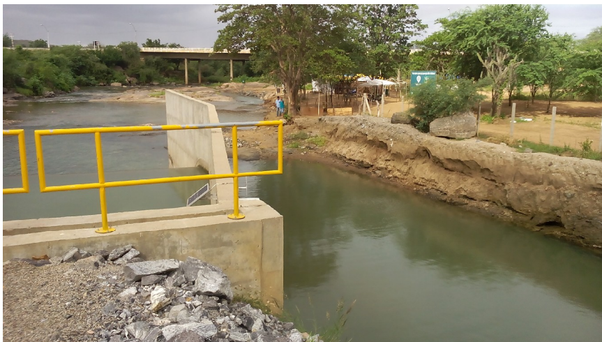
Figura 1: Canal desaguando esgoto na calha do Rio Paraíba ao lado do canal da Transposição
