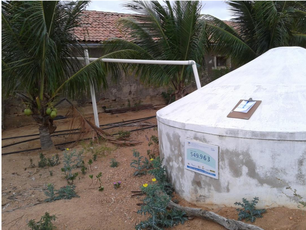
Figura 2. Área de captação e armazenamento com o sistema de calhas e tubulações
