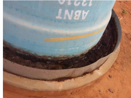
Figura 2: Detalhe da área de perda de biogás para o ambiente. Fonte: Arquivo dos autores.
