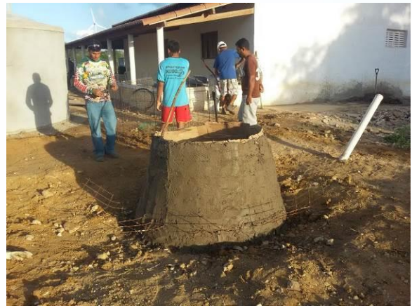
Figura 17: Boca cônica do biodigestor Fonte: Produção dos autores
