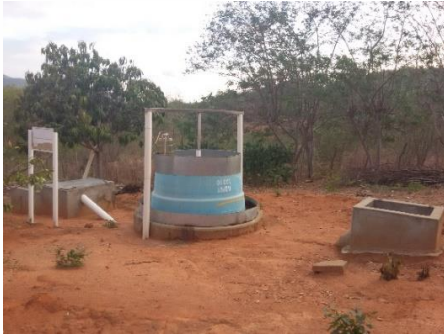
Figura 1: Biodigestor Sertanejo, instalado na área experimental da ONG CEPFS, em Teixeira (PB). Fonte: Arquivo dos autores.
