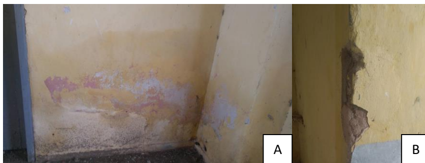
Figura 5- Degradação e desprendimento da (A) Pintura (B) Argamassa.
