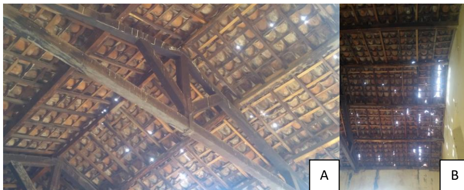
Figura 4- Degradação das estruturas do telhado (A) Ripas, Caibros e Tesoura (B) Falta de Telhas
