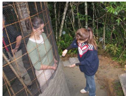
Figura 2: Cisterna tela-cimento. Fonte: ACM, (2010).
