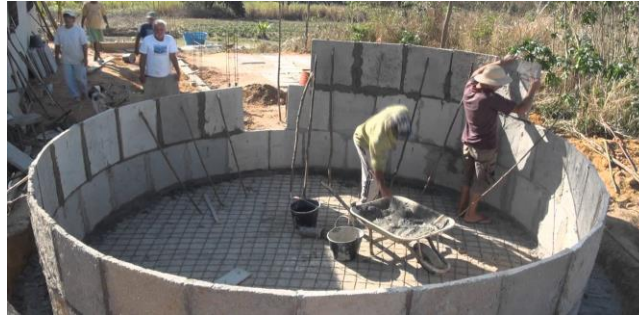
Figura 1: Cisterna rural de placas pré-moldadas. Fonte: UFRRJ, (2011).
