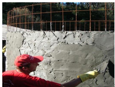
Figura 3: Cisterna ferro cimento. Fonte: CCTDI, (2014).
