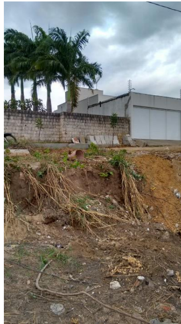
Figura 4 Área de Erosão Fonte: Autoria Própria
