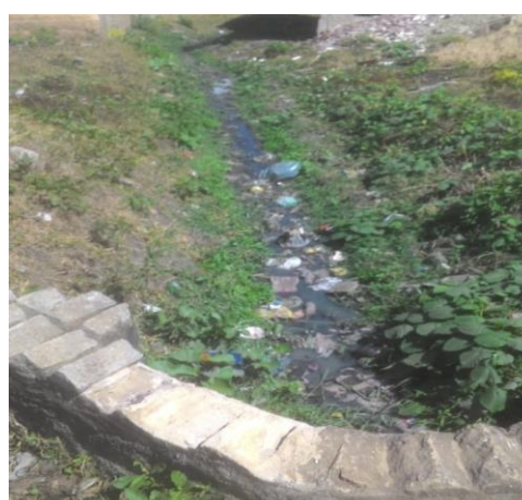
Figura 6 - Córrego contaminado por esgoto.
