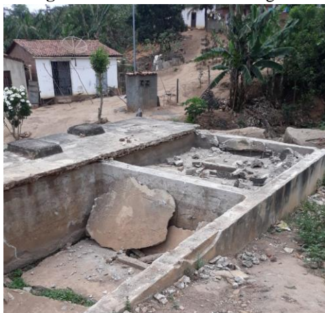
Figura 3 - Caixa de coleta de esgoto.
