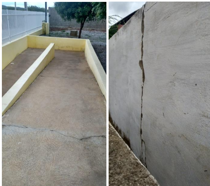
Imagens 7 e 8: Trincas no piso e rachaduras na alvenaria
