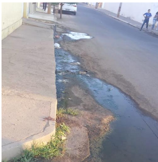
Figura 2: Esgoto a céu aberto.
