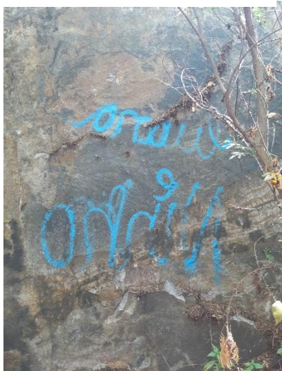
Figura 5: Pichações nos taludes
