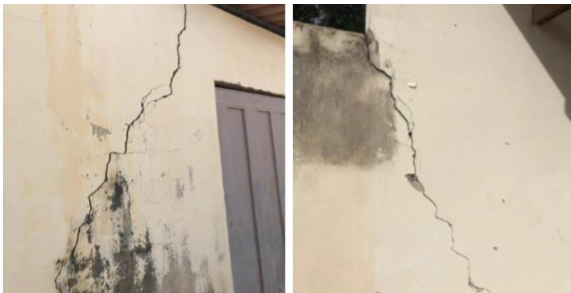
Figura 03 – a) Vista externa da parede trincada de características transversais; b) Trinca em parede externa de edificação.
