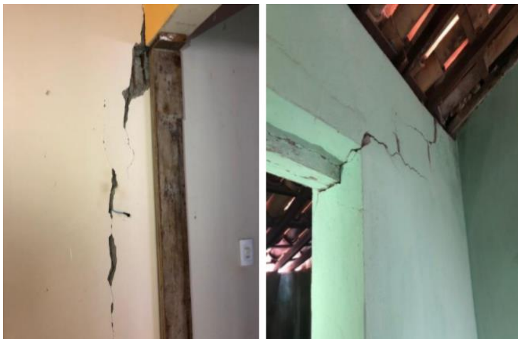
Figura 04 – a) Rachaduras internas expondo a armadura; b) Rachaduras internas nos vértices de abertura.
