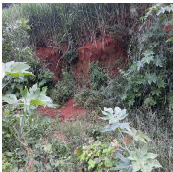
Figura 9: Processo erosivo às margens do riacho no Sítio Icó
