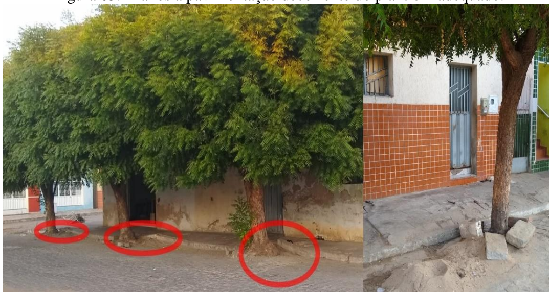
Figura 05. Danos a pavimentação decorrente do plantio inadequado.
