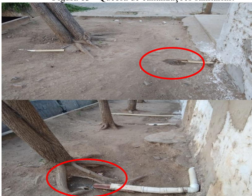
Figura 03 - Quebra de canalizações sanitárias.
