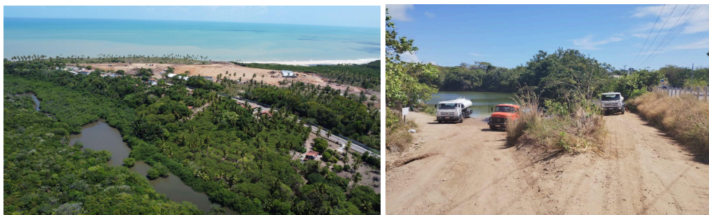
Figura 3 e 4: Obras do Polo Turístico no limite com a APA e o parque; e carros-pipas retirando água do rio Jacarapé.
