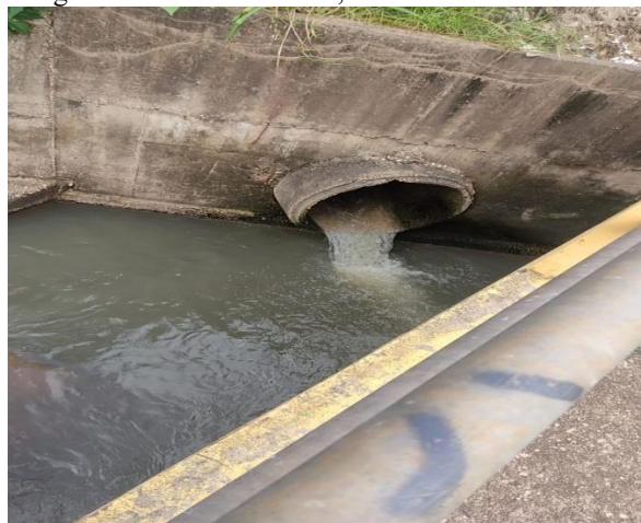
Figura 2: Descarte de esgoto no Riacho do Meio, afluente do Riacho Bacuri em Imperatriz -MA
