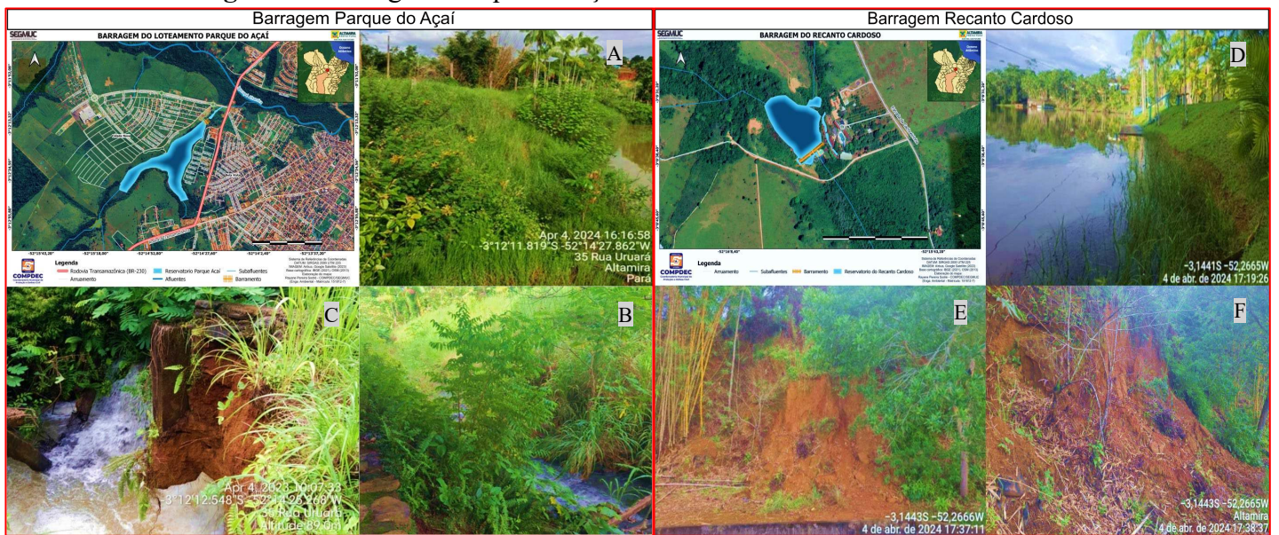
Figura 2 - Barragens Parque do Açaí e Recanto Cardoso e anomalias observadas.
