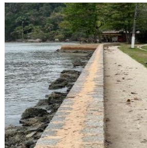
Figura 2 - Obra de contenção no mesmo ponto da reportagem com a inexistência da faixa de areia. Fonte: autora, 2023
