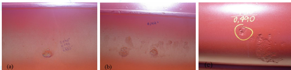
Figura 1: (a, b, c) Defeito de corrosão
