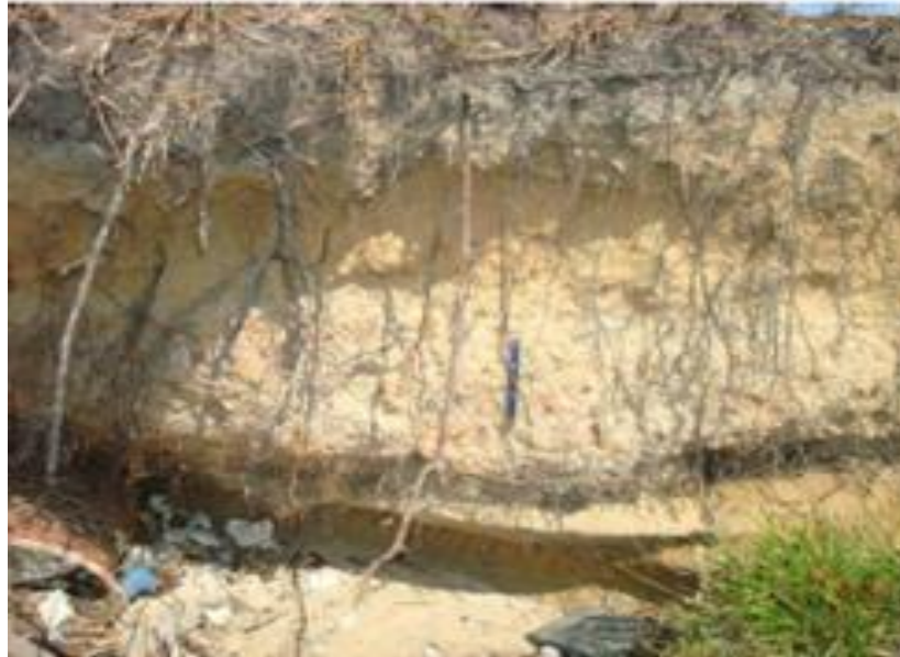
Figura 10. Foto mostrando em detalhe a erosão na orla do rio Guamá na UFPA, fazendo a comparação ilustrativa com uma caneta ao centro. Dias (2011).
