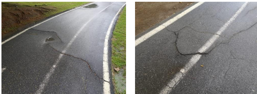
Figuras 15 e 16 – Fissuras na pista de caminhada do local em estudo
