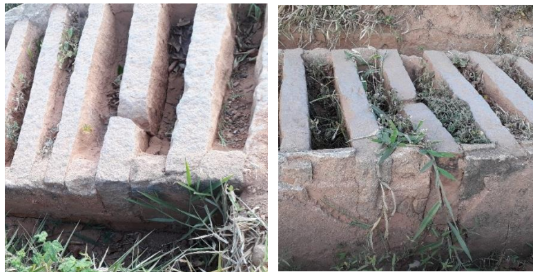
Figura 2: Defeitos nos mata-burros de pedra, trincas e falta de pasta cimentante. Fonte: Autores (2018).
