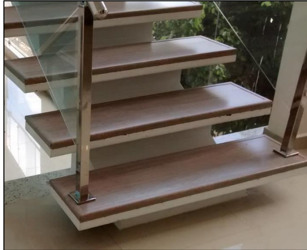
Figura 5 – Detalhe de degrau da escada com revestimento em madeira laminada.
