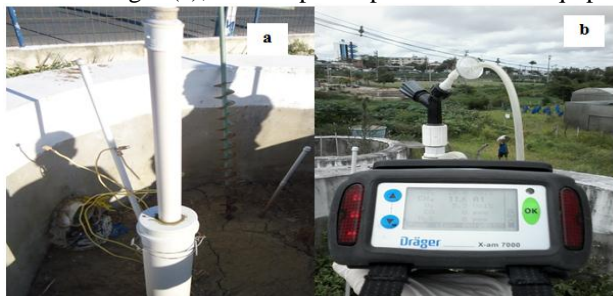
Figura 2 - Dreno de gás (a); saída superior para entrada do equipamento (b).
