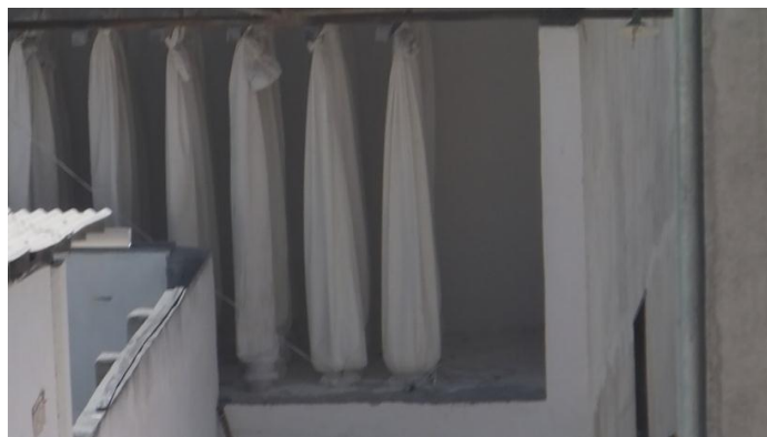
Figura 1: Filtros de manga para retenção de material particulado. Fonte: Própria, 2014.
