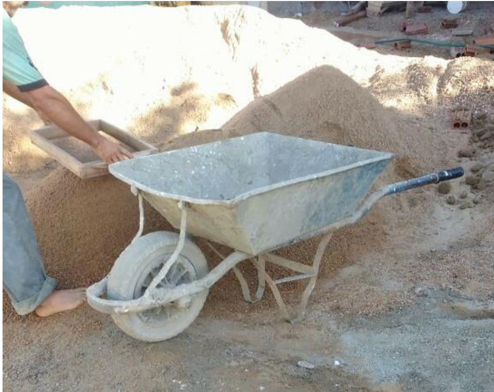
Figura 03 – Ausência de EPI's em uma das obras visitadas Fonte: autoria própria
