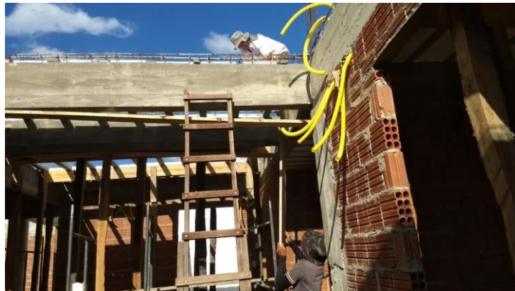
Figura 1: Escada de mão inadequada de acordo com a NR 18.
