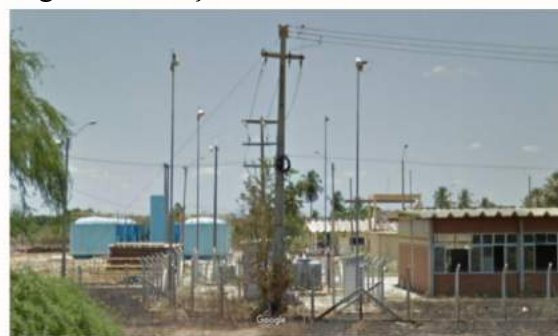
Figura 5: Estação de Tratamento J. Rosado
