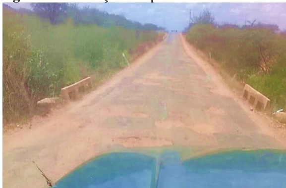
Figura 4 – Condições do pavimento da RN – 081.
