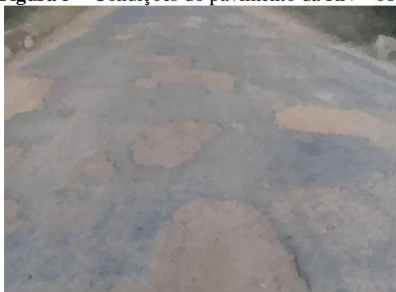
Figura 5 – Condições do pavimento da RN – 081.
