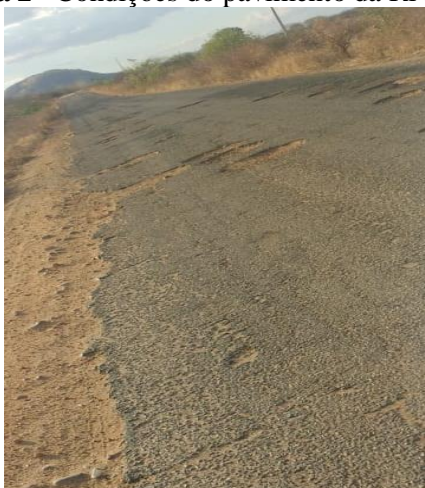
Figura 2 – Condições do pavimento da RN – 081.
