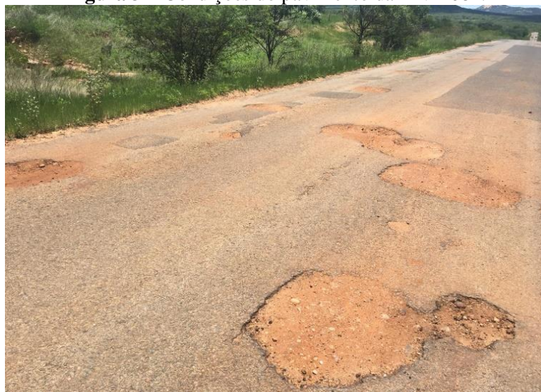
Figura 3 – Condições do pavimento da RN – 081.
