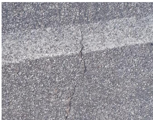
Figura 2 – Fissuras na superfície.
