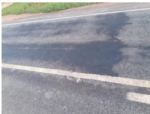
Figura 4 - Exsudação no pavimento.
