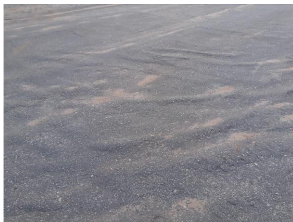
Figura 6 – Ondulações no pavimento.
