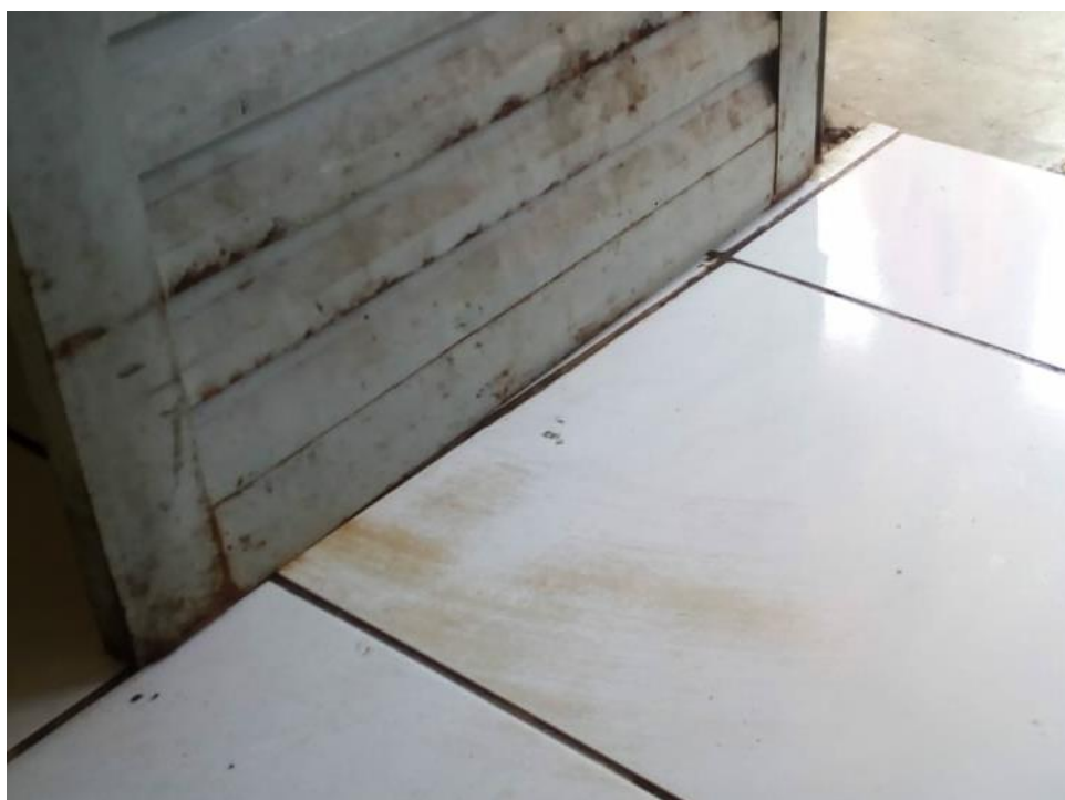
Figura 6 – Revestimento cerâmico com desgastes.
