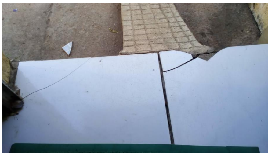
Figura 5 – Revestimento cerâmico quebrados nas aberturas de vãos.
