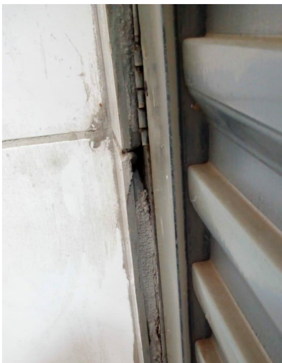
Figura 3 – Deficiência na aderência das placas cerâmicas.
