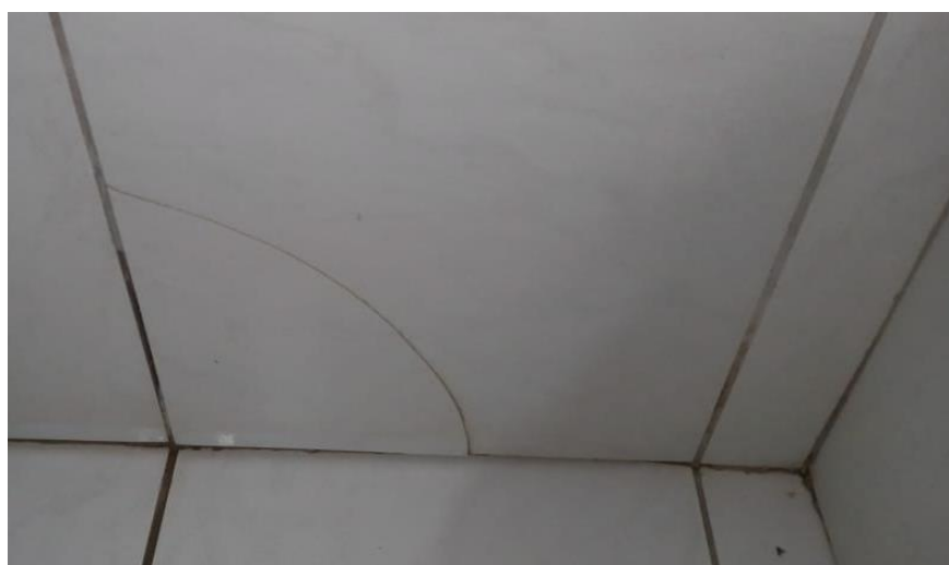
Figura 4 – Revestimento cerâmico trincados nos ambientes úmidos.
