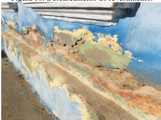
Figura 10: Descascamento do revestimento.
