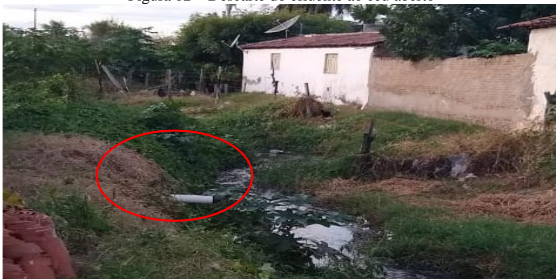
Figura 02 – Descarte do efluente ao céu aberto
