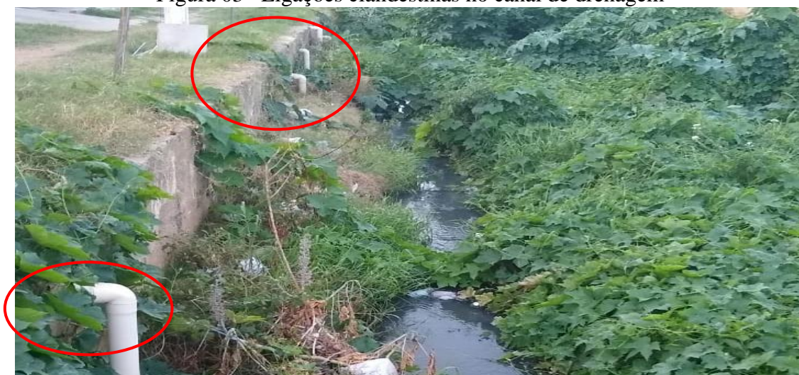
Figura 03 –Ligações clandestinas no canal de drenagem
