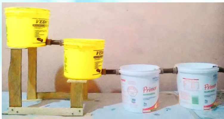
Figura 1: Estação de tratamento de águas cinza.
