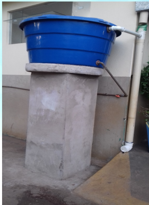
Figura 1 – Sistema de coleta de água de chuva confeccionado.
