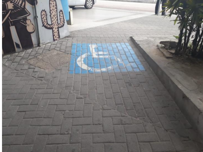
Figura 08: Rampa PNE sem piso tátil de alerta.
