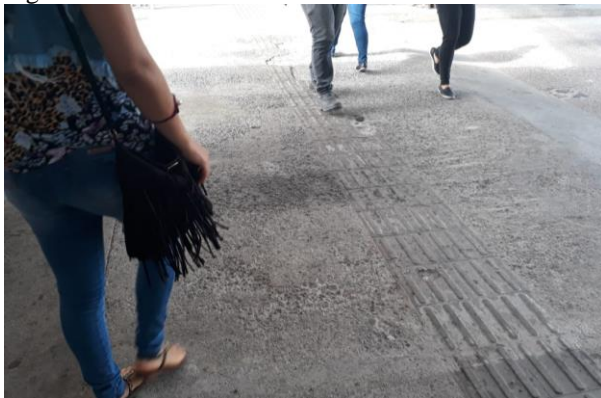
Figura 04: Piso tátil deteriorado.
