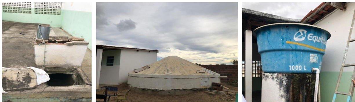
Figura 3 – Visão das cisternas e caixa d'água da Escola Municipal de Alcantil-PB.
