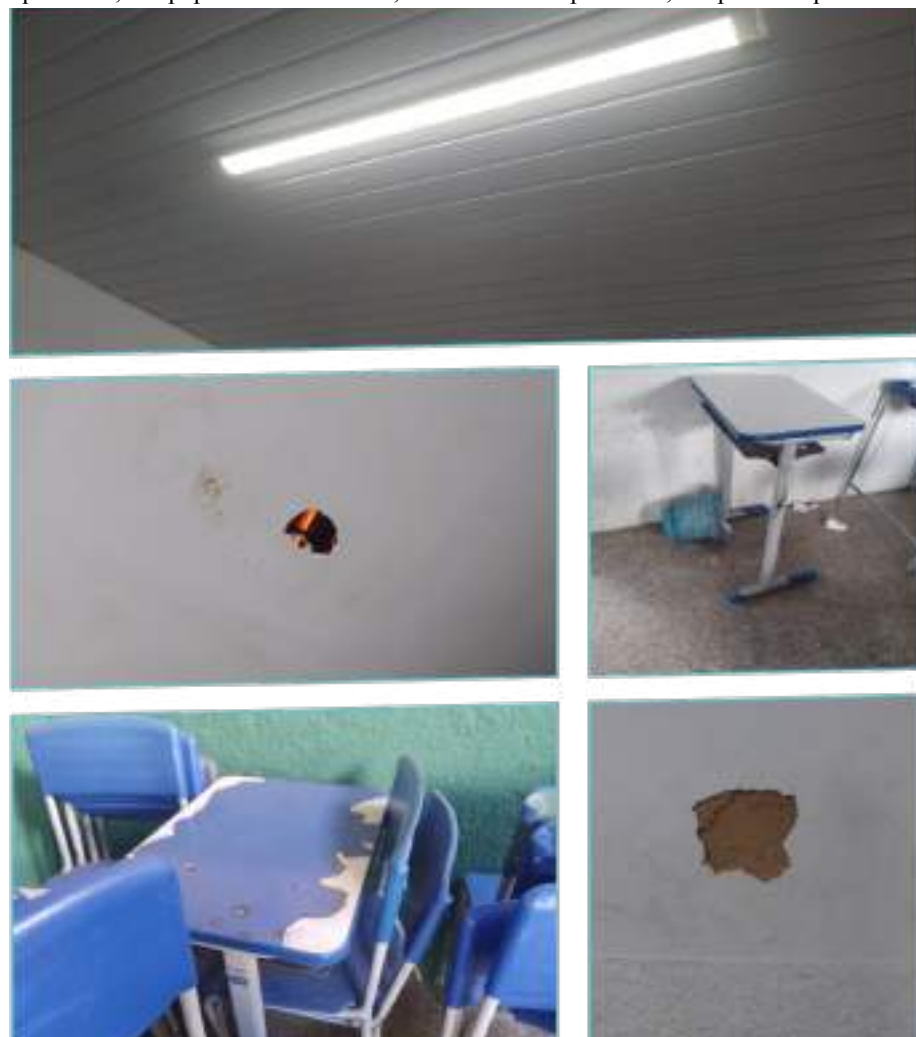
Figura 1 - Problemas encontrados nas dependências internas na sala de aula; A - lâmpadas acesas; B - teto quebrado; C - papéis fora da lixeira; D - carteiras depredadas; E - paredes quebradas.
