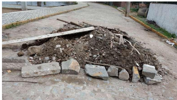
Figura 7 - Entulho no meio da passagem de carros na UFCG
