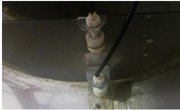
Figura 9: Detalhe dos sensores de níveis instalados na placa vertedoura.
