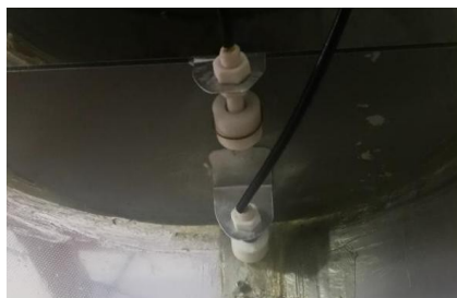
Figura 6: Detalhe dos sensores de níveis instalados na placa vertedoura.
