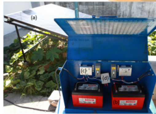
Figura 08. (a) Painel fotovoltaico. (b) Bateria estacionária. (c) Controlador de carga. (d) Micro controlador Arduído.
